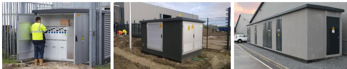
Figuur 22. Voorbeelden van verschillende inkoopstations voor GV-aansluitingen. Bron: Joulz, Fudura, Batenburg Energietechniek.
