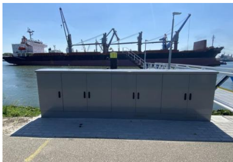
Figuur 26: voorbeelden van elektrische infrastructuur op de kade. Links een aansluiting voor walstroom op een drijvende pier. Rechts toont een waterdichte installatie voor walstroom. Bron: Connect4Shore
