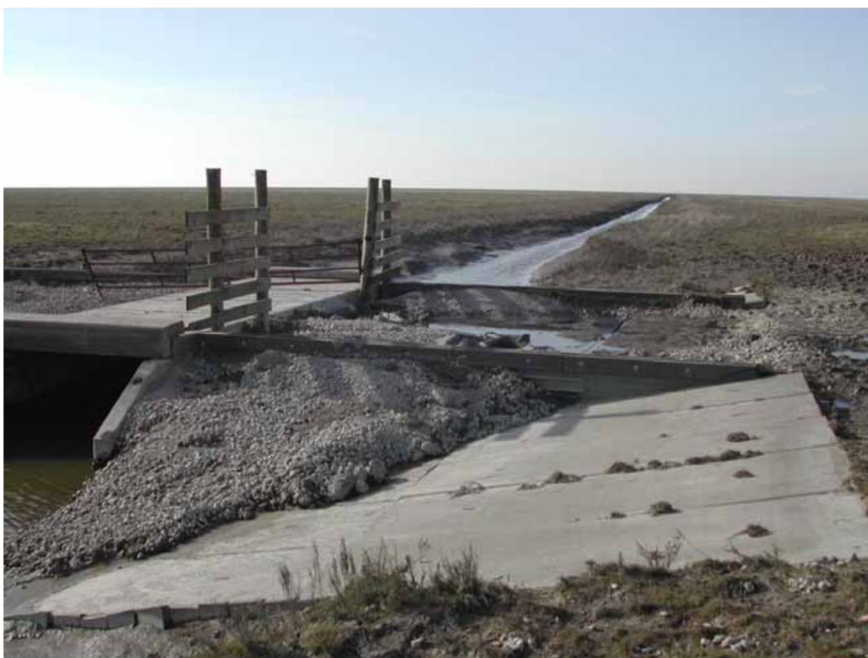
Foto 5.1 Erosie rond brug/duiker middelste doorgraving in maart 2005.
